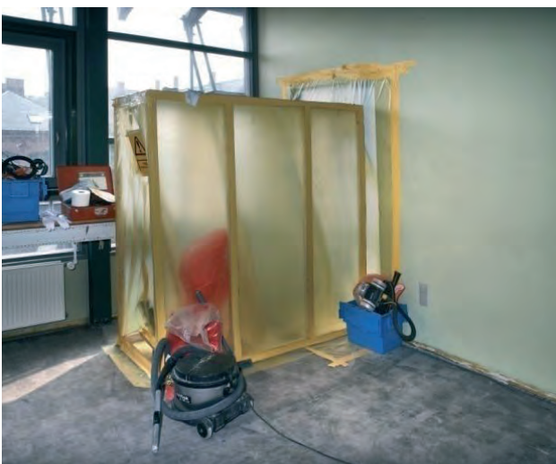
Eksempel på adgangssluse
